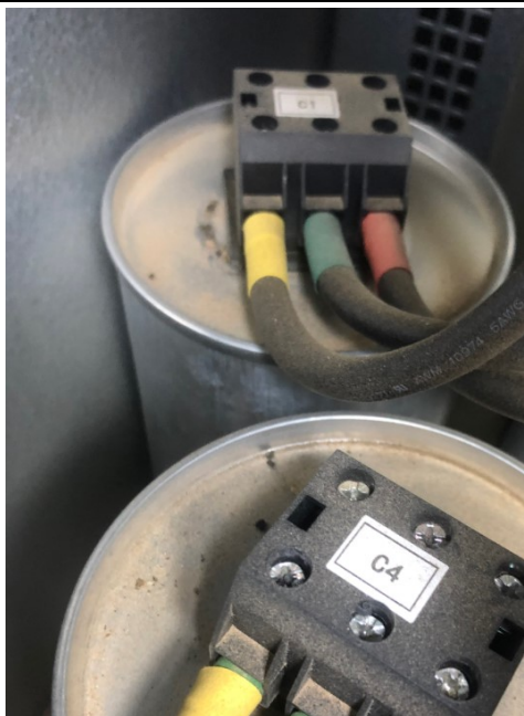
Checking, cleaning all AC capacitors/ kiểm tra và làm sạch tất cả các tụ AC
