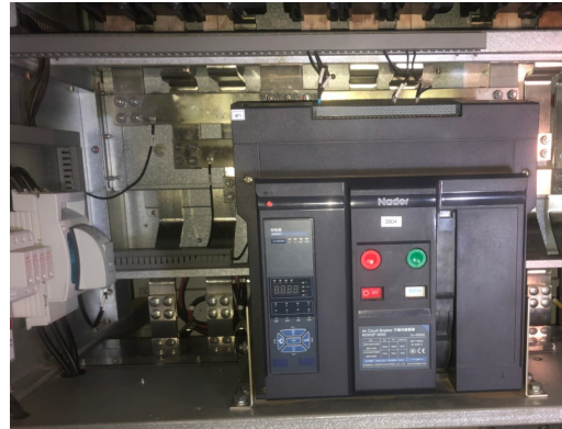
Checking, cleaning AC busbar, AC breaker/ Kiểm tra và làm sạch busbar AC và máy cắt AC
